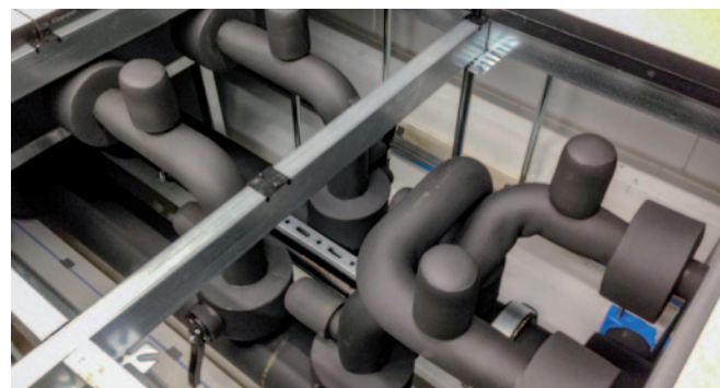
Keurig geïsoleerd met kappen tegen condenseren.
