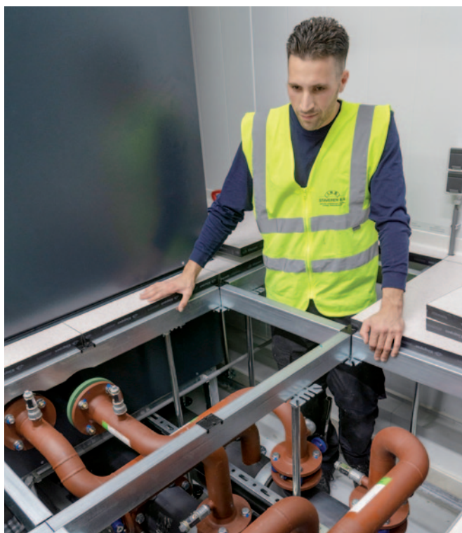
Alle computerkasten hebben onder de computervloer minimaal twaalf flensverbindingen.
